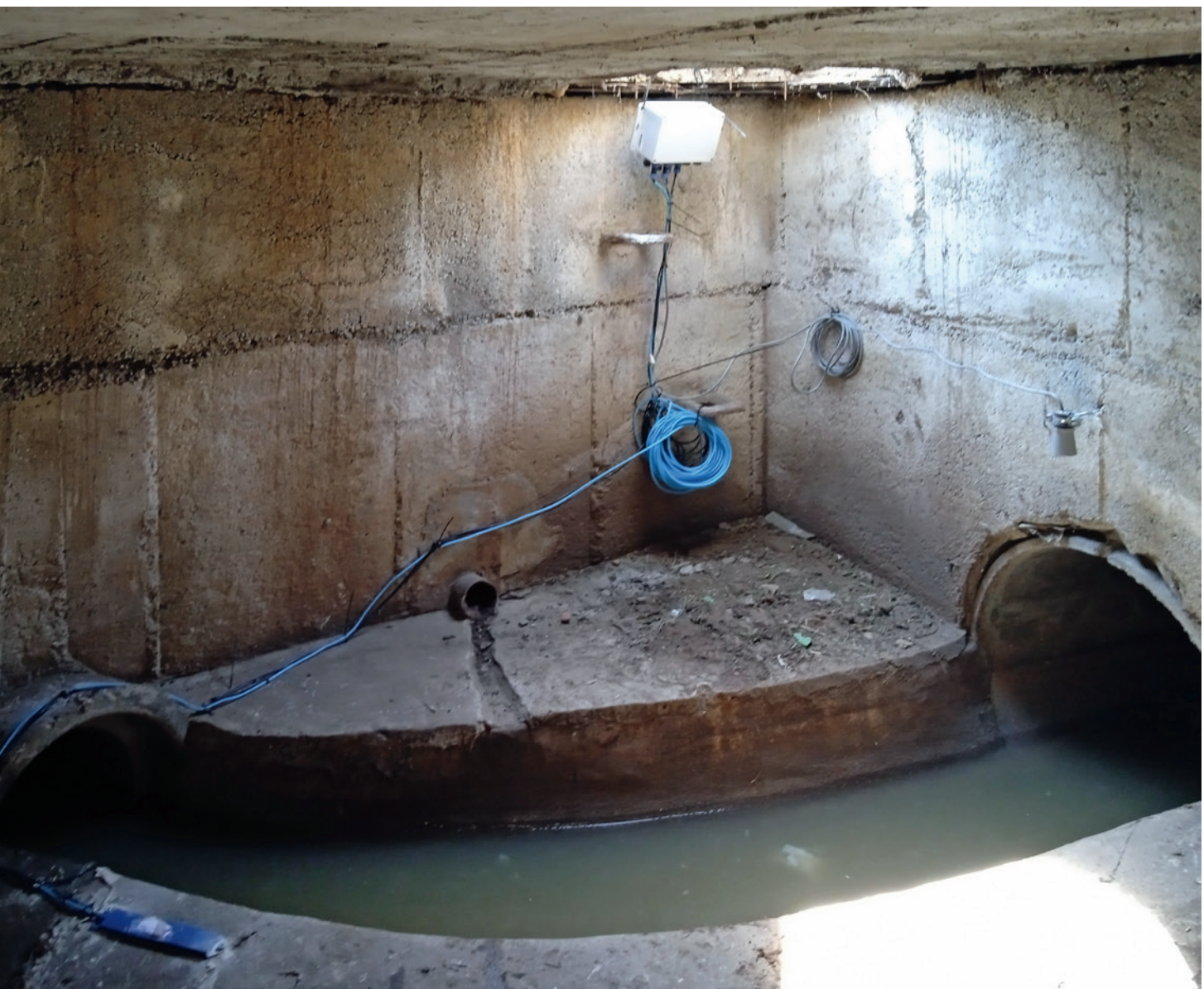
Abb. 5: Installation der Sensoren an der Überlaufschwelle in Sofia
